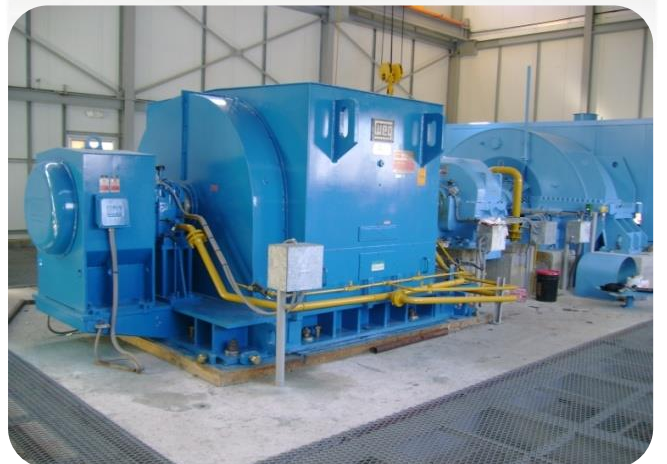
Montaje de Turbina TGM para cogeneración de 14MB en Planta de Cogeneración.
